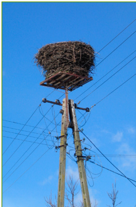
Wysokie i ciężkie gniazdo wymagające odciążenia. Fot. AT
