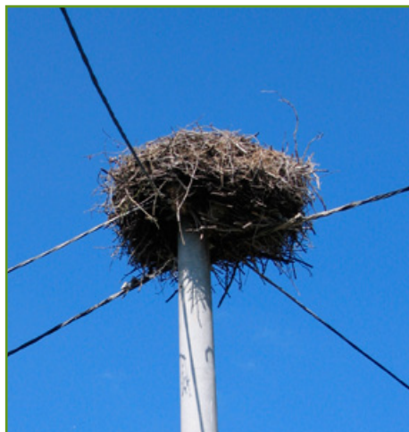
Gniazdo na zmodernizowanej linii elektroenergetycznej (przewody w czarnej izolacji są splecione w warkocz). Fot. AT
